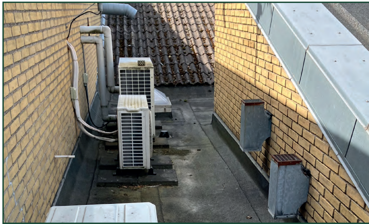
Billede 1: Tekniske installasjoner på tagfladen.
