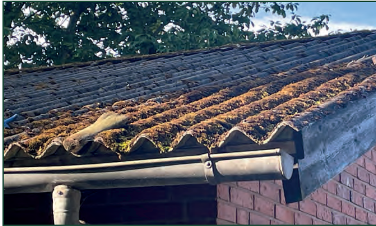
Billede 1: Asbestholdige bølgeplader med mos.
