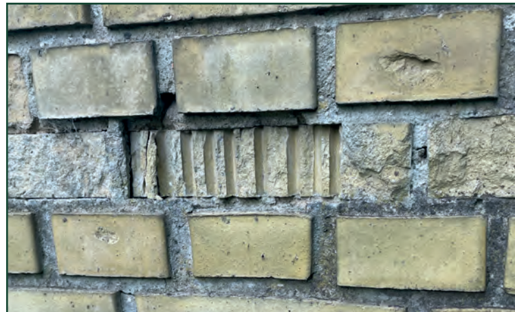
Billede 4: Beskadiget murværk Beskadiget murværk.
