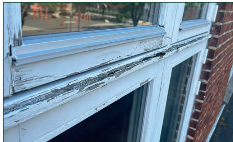
Billede 4: Nedbrudte trævinduer.
