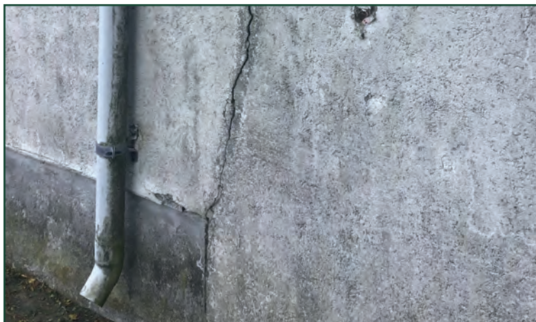
Billede 3: Facadeisolering er en dårlig løsning
