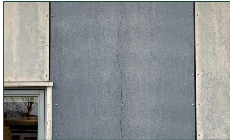
Billede 3: Revnede facadeplader.
