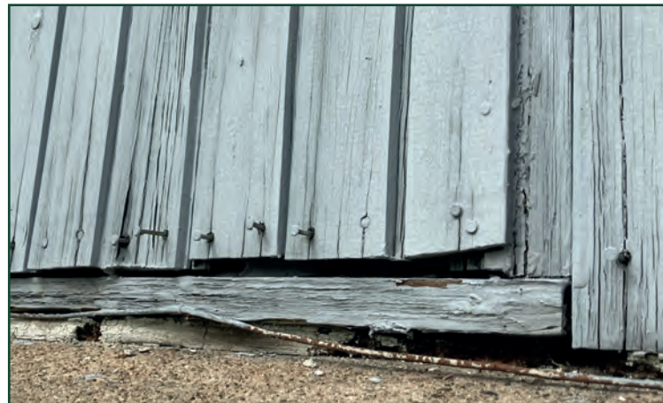
Billede 2: Træbeklædning viser tydelig tegn på manglende vedligehold.
