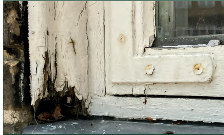
Billede 2: Nedbrudte trævinduer.
