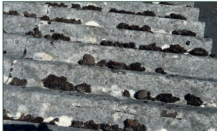
Billede 2: Revnede og nedslidte bølgeplader.
