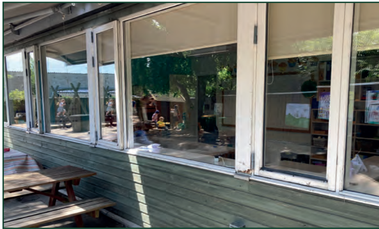
Billede 1: Dårligt isolerede lette facadepartier.
