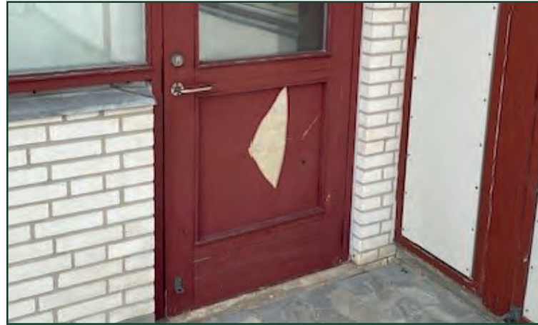
Billede 2: Facadedøre nedslidte.
