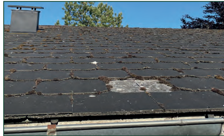
Billede 2: Asbestholdige skifereternit.
