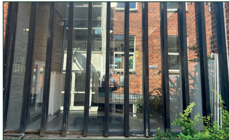
Billede 2: Nedbrudte træpartier.
