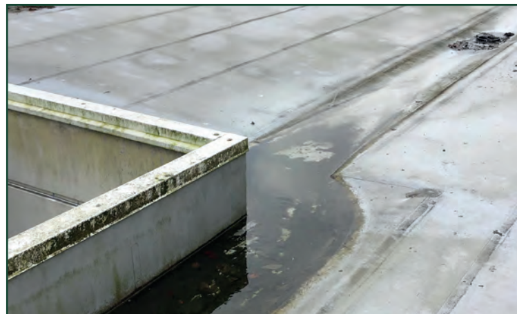
Billede 4: Regnvand ledes ikke til tagbrønd.
