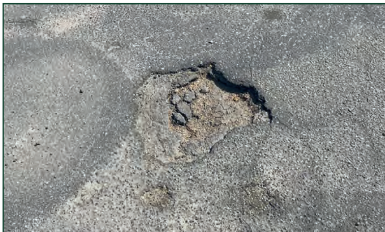
Billede 2: Hul i asfalten efter en våd og kold vinter.
