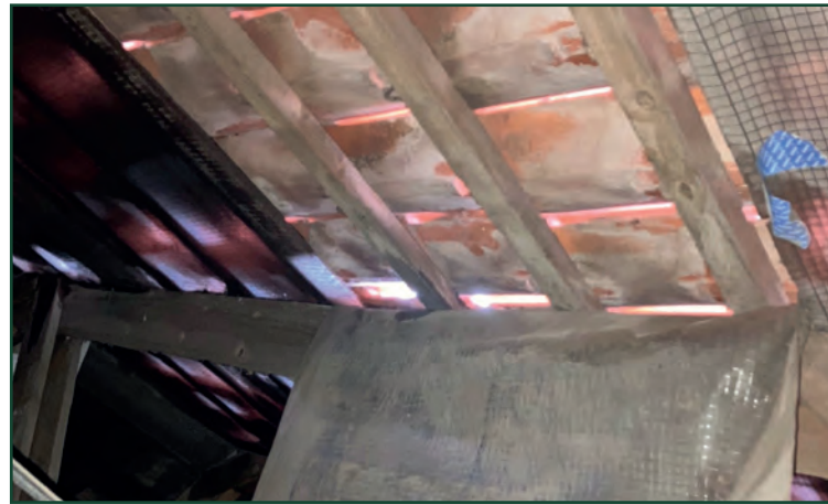
Billede 2: Undertag er nedbrudt.
