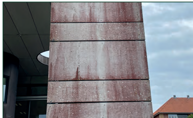
Billede 2: Algevækst på bygningens klimaskærm.
