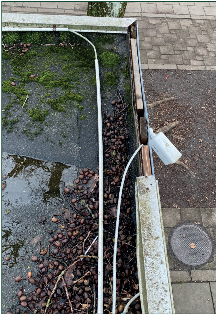
Billede 1: Tagkonstruktion bærer præg af manglende vedligeholdelse.
