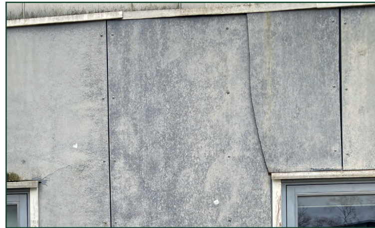
Billede 2: Revnede facadeplader.
