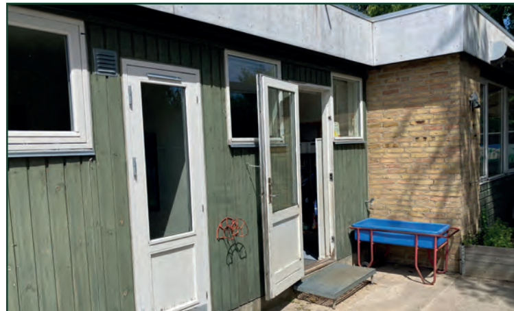
Billede 4: Dårligt isolerede lette facadepartier + dårlig tilgængelighed.
