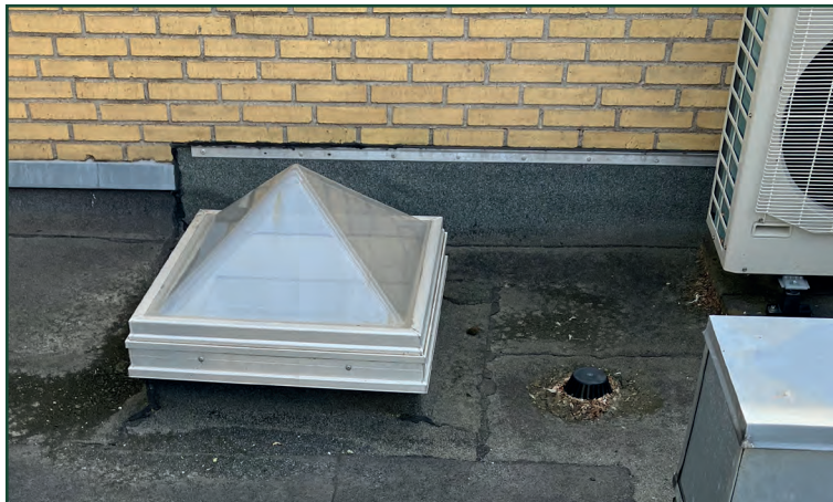
Billede 3: Ovenlys og tekniske installasjoner = risiko på utæthed.
