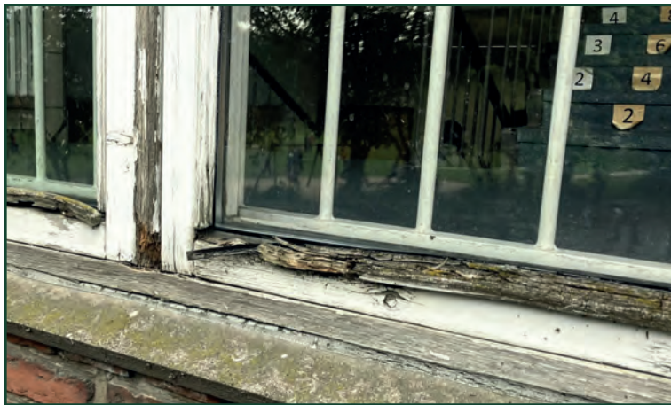
Billede 1: Nedbrudte trævinduer.
