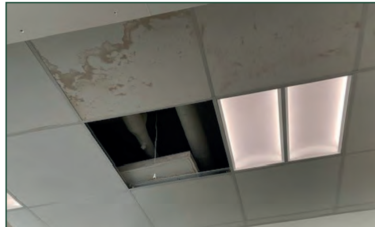
Billede 4: Loftplader viser tydelige tegn på vandindtrængning.
