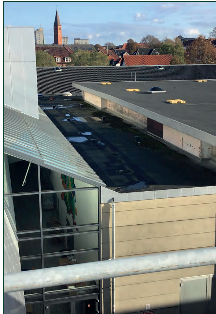
Billede 3: Regnvandet bliver ikke ledt til en tagbrønd.
