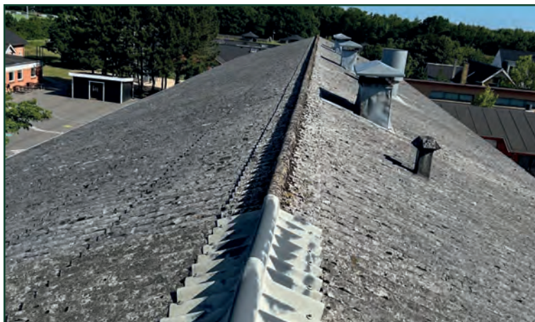
Billede 3: Revnede og nedslidte bølgeplader..
