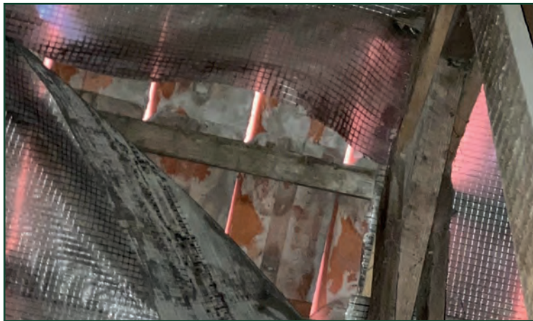
Billede 3: Undertag er nedbrudt.
