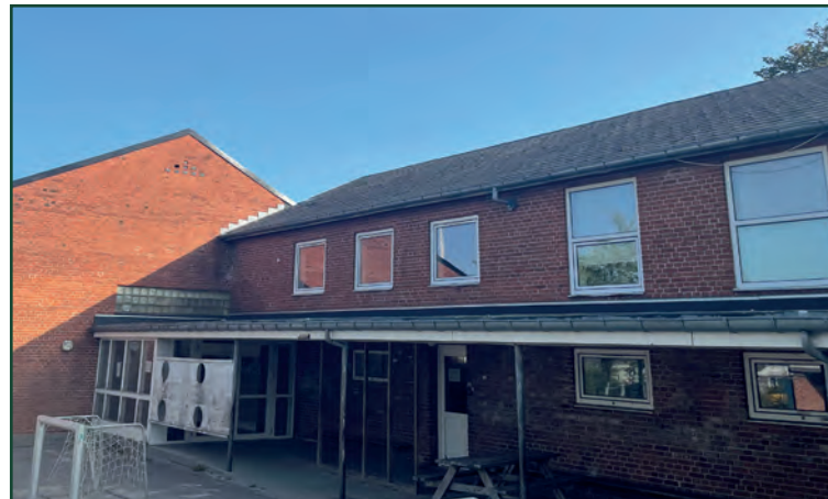
Billede 4: Asbestholdige bølgeplader med mos.
