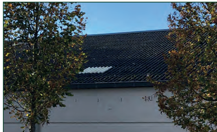
Billede 4: Det gamle asbestholdige bølgepladetag.
