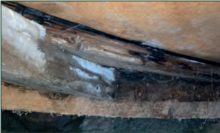
Billede 3: Utætheder i tagkonstruktionen.
