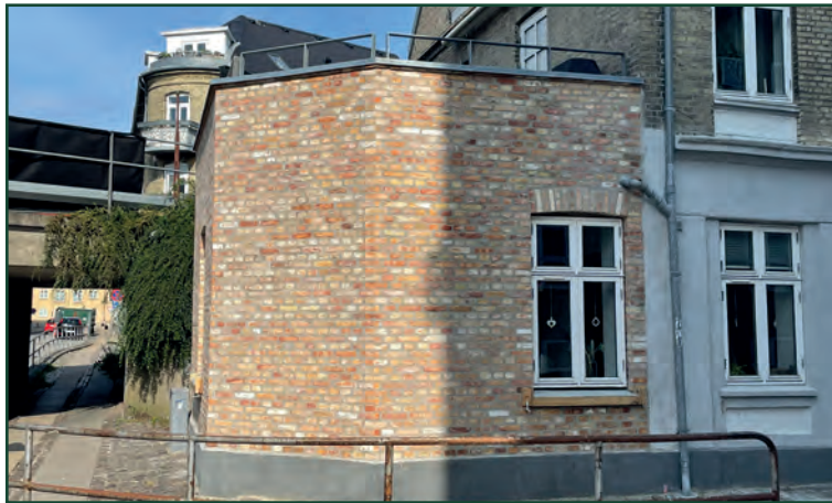
Billede 1: Poul Paghs Gade 1 efter energireovering.
