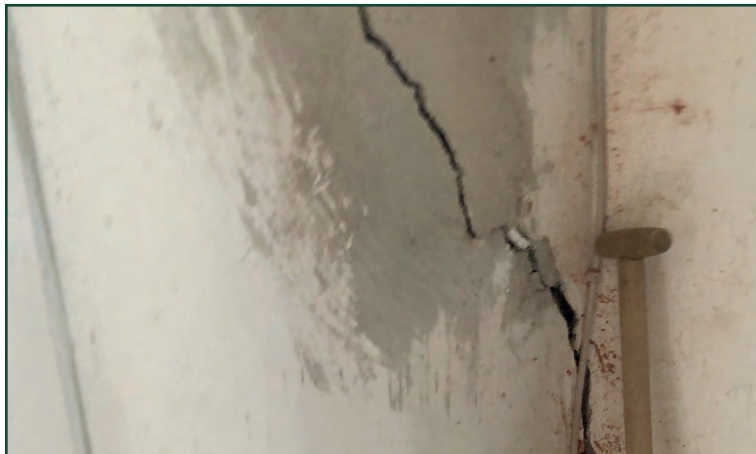
Billede 3: Revnedannelse i murværk.
