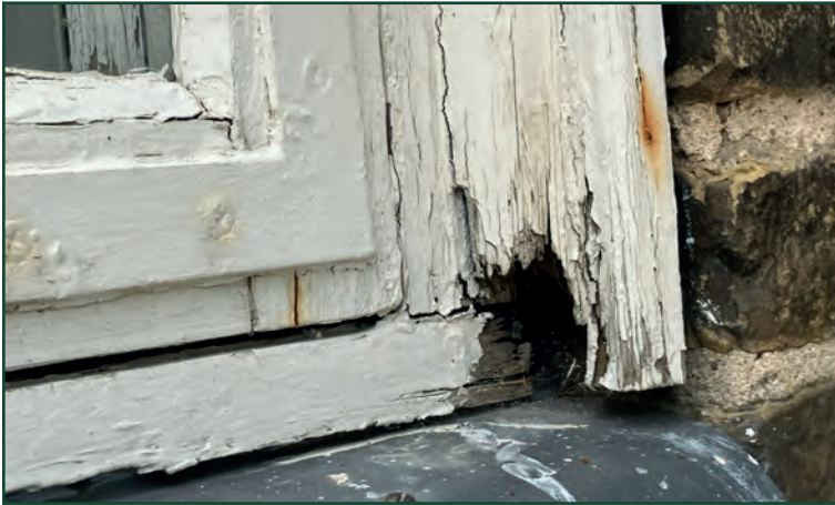
Billede 1: Nedbrudte trævinduer.
