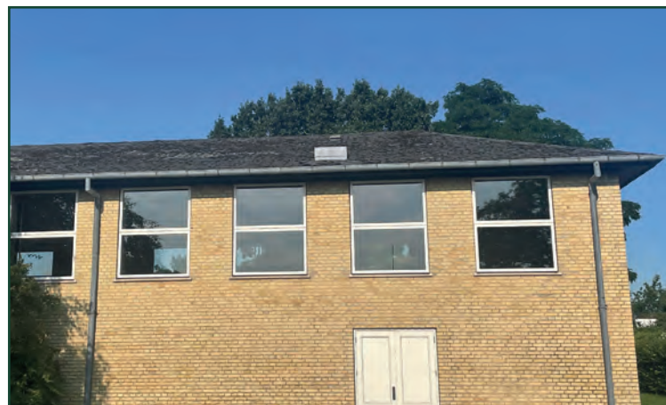
Billede 4: Asbestholdig eternitskifer med mos.
