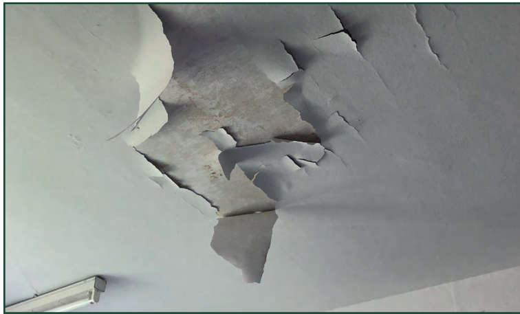
Billede 1: Loftmaling slipper grundet høj fugtpåvirkning.
