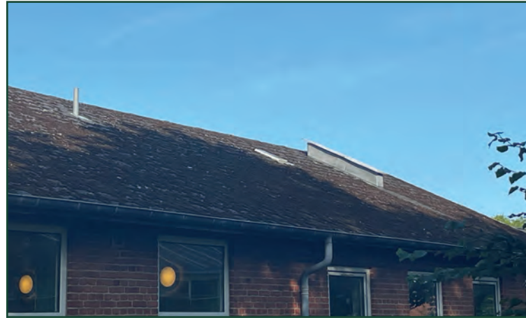
Billede 2: Asbestholdige bølgeplader med mos.
