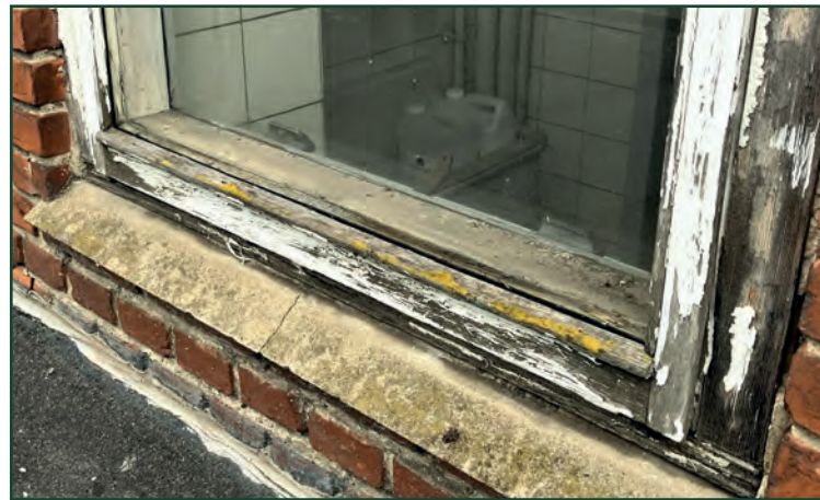
Billede 2: Nedbrudte trævinduer.
