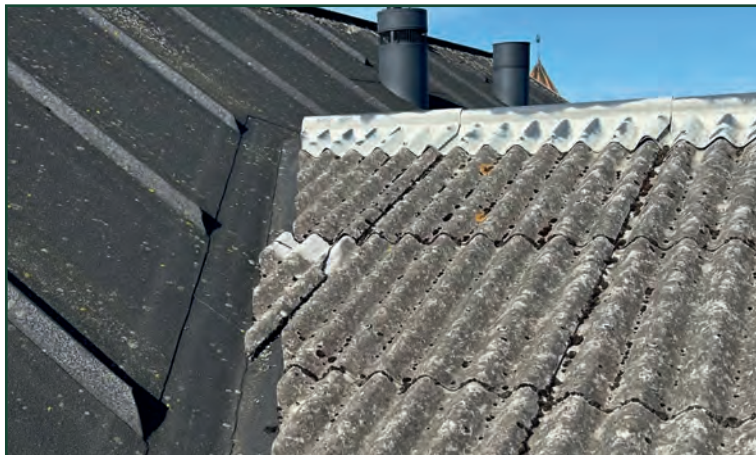
Billede 1: Revnede asbestholdige bølgeplader.
