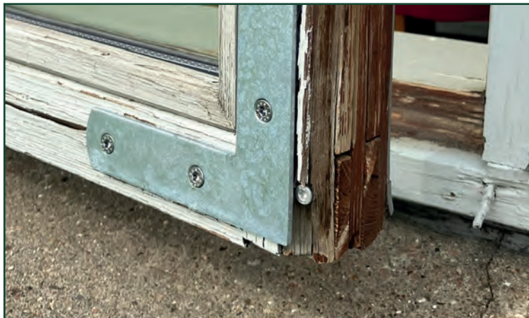
Billede 1: Trævinduer er nedbrudte.
