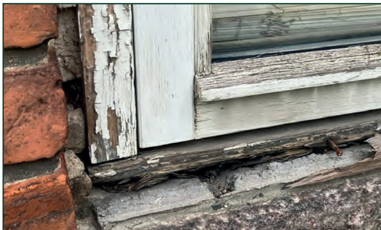
Billede 3: Nedbrudte trævinduer.
