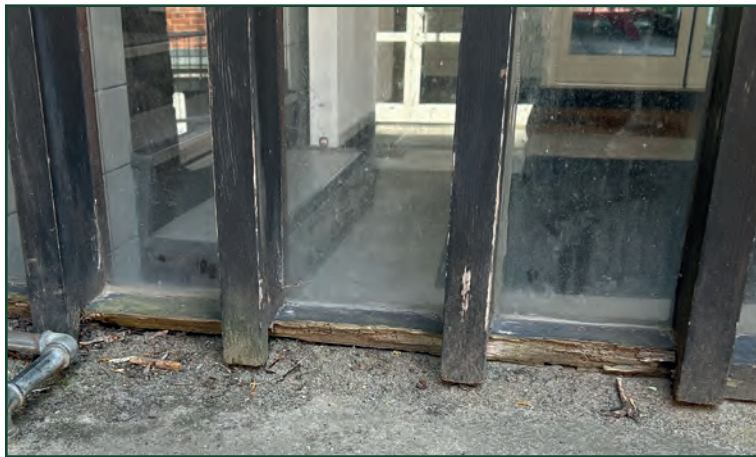
Billede 1: Nedbrudte træpartier.
