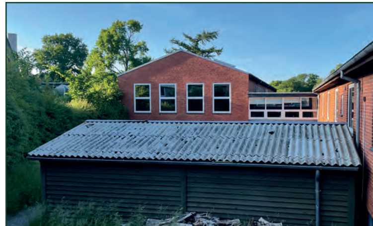
Billede 4: Bølgeplader af eternit indeholder sandsynligvis asbest.
