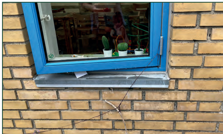
Billede 1: Murværk var opfugtet og i dårlig stand.
