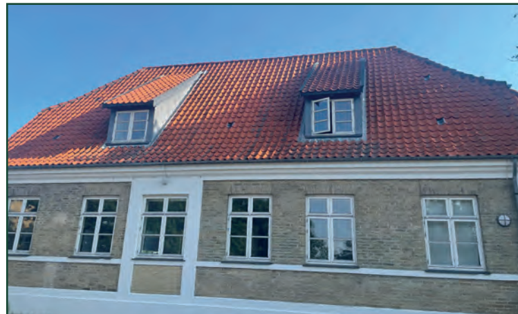
Billede 2: Flot bygning, men taget er utæt.
