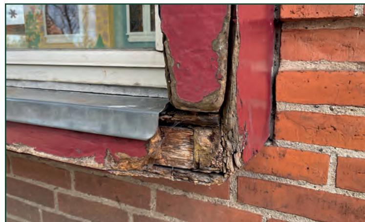
Billede 4: Træværk er nedbrudt og trænger til udskiftning.
