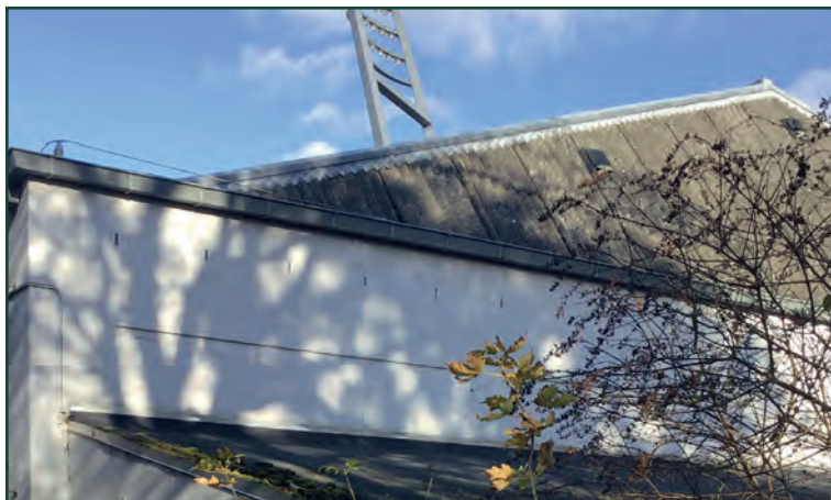
Billede 3: Det gamle asbestholdige bølgepladetag.
