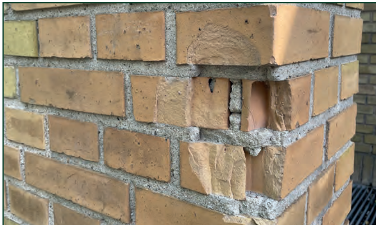
Billede 3: Beskadiget murværk.
