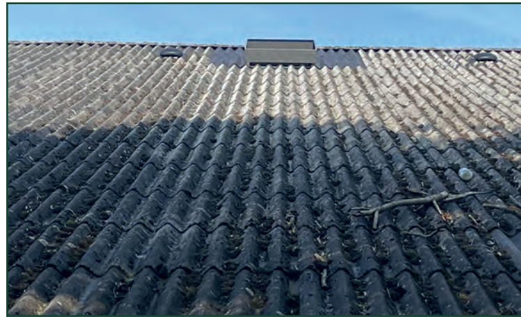
Billede 2: Nedslidte bølgeplader.
