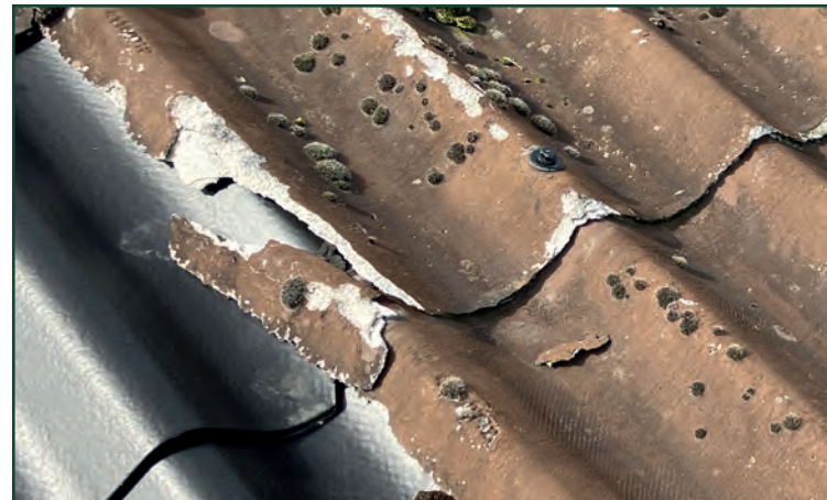
Billede 4: Nedbrudte eternit bølgeplader.
