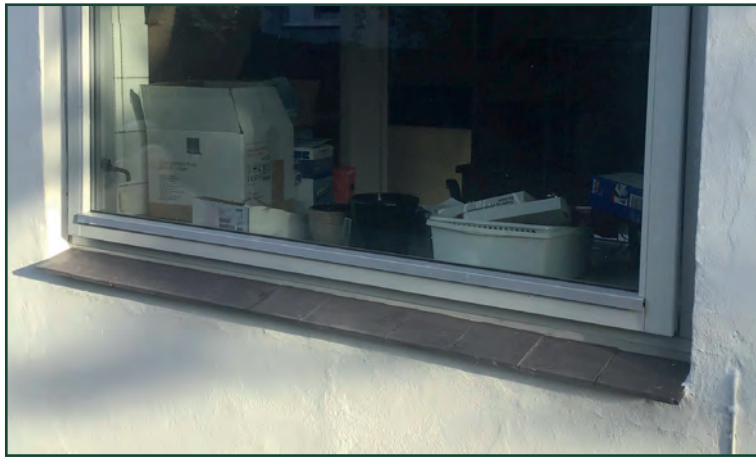
Billede 1: Ældre og utætte termovinduer af træ.
