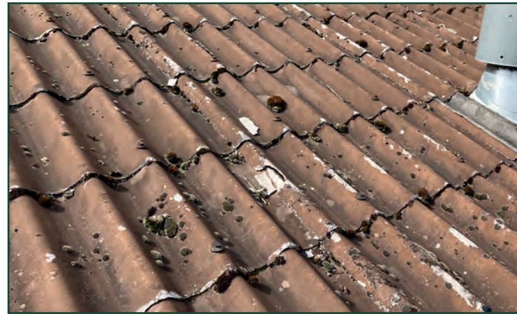
Billede 2: Nedbrudte eternit bølgeplader.
