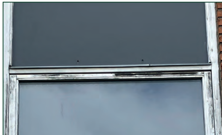
Billede 4: Nedbrudte trævinduer og blændfelter.
