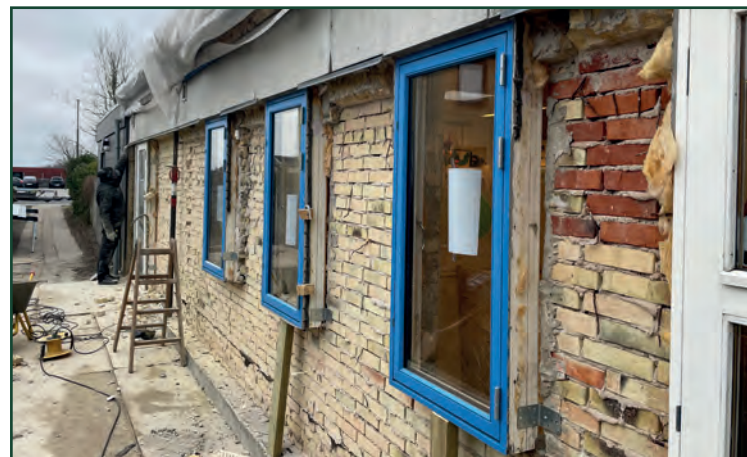
Billede 2: Formur nedbrudt sammen med gennemtærede murbindere.
