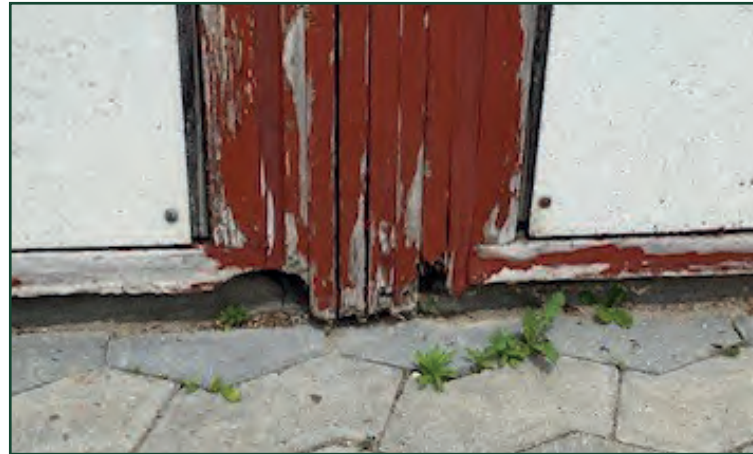
Billede 4: Nedbrudt træværk.
