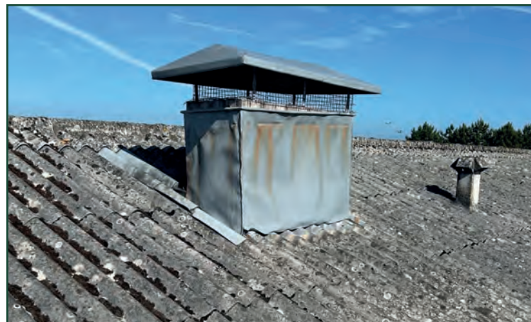
Billede 4: Revnede og nedslidte bølgeplader..
