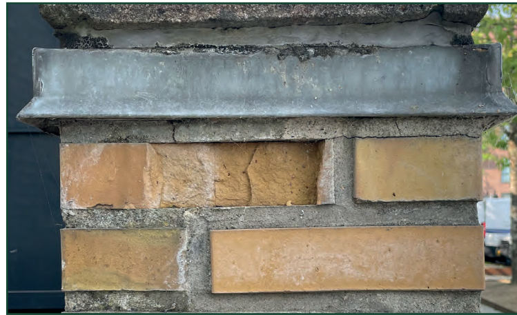
Billede 2: Beskadiget murværk.
