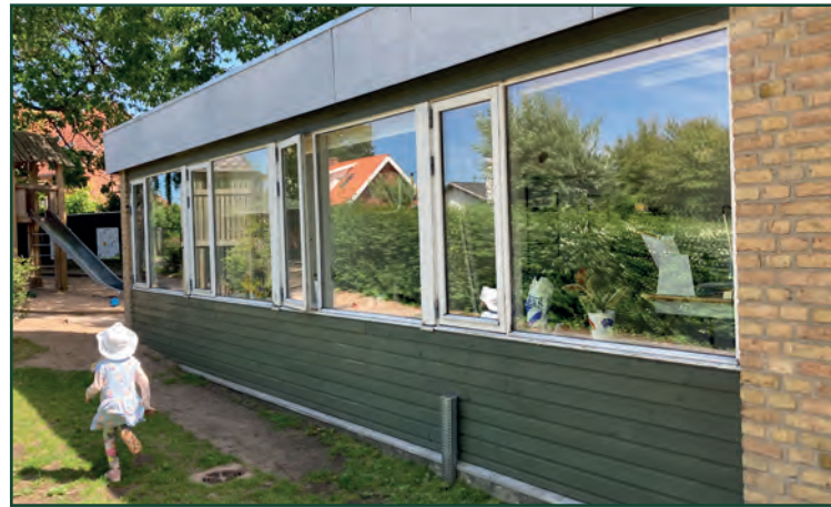
Billede 2: Dårligt isolerede lette facadepartier.
