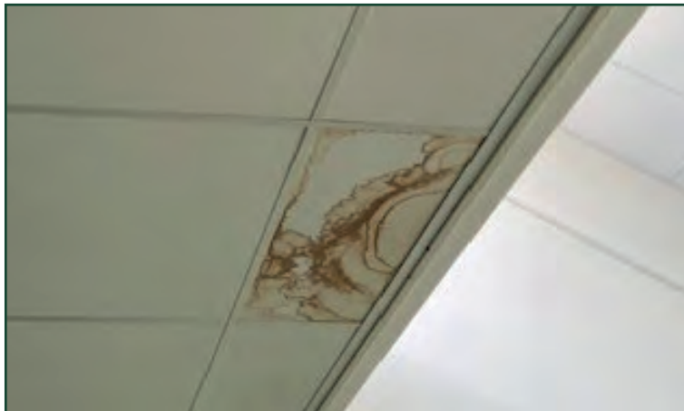
Billede 3: Loftplader viser tydelige tegn på vandindtrængning.
