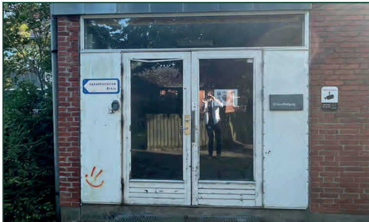
Billede 3: Ældre og utæt facadedør.
