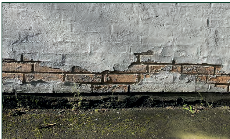
Billede 3: Overfladebehandling trænger til vedligehold.
