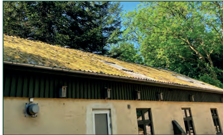
Billede 4: Nedbrudt træværk.
