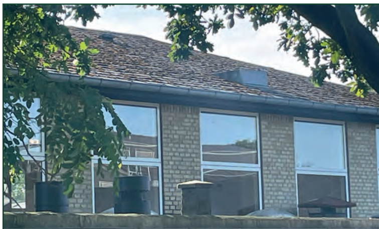
Billede 3: Asbestholdig eternitskifer med mos.
