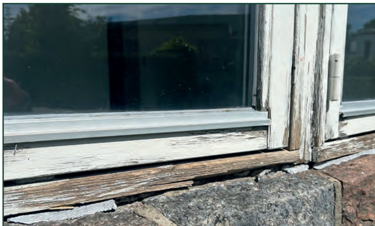
Billede 3: Nedbrudte trævinduer.
