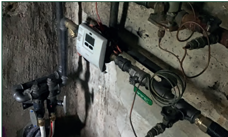
Billede 2: Tekniske installationer mangler isolering.
